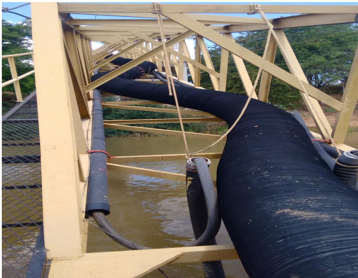
Figura 7 – Captação no Rio São Francisco
